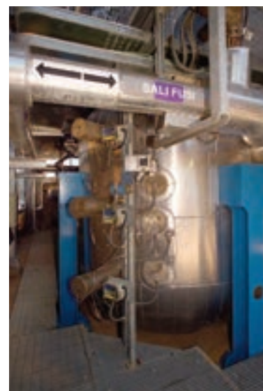
Serbatoio presente nell'impianto sperimentale PCS
