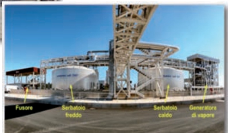
Impianto Archimede (Priolo Gargallo SR)
