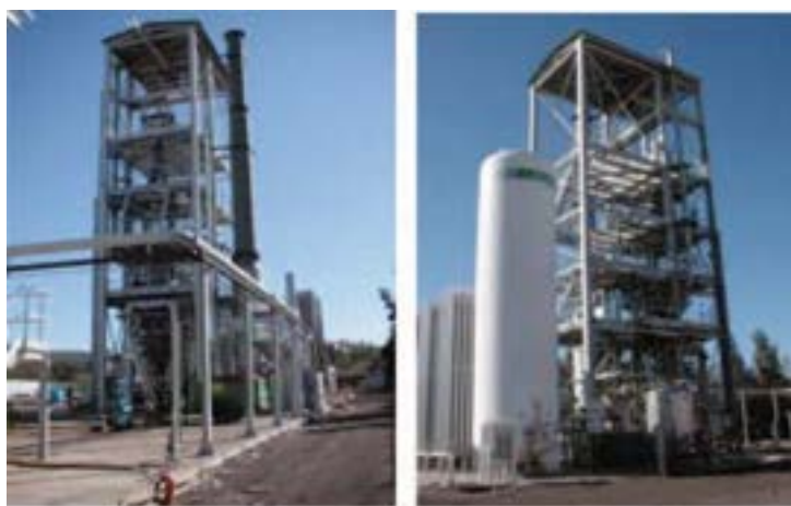
ENEA/SOTACARBO Piattaforma pilota per la produzione di energia elettrica e idrogeno da carbone
