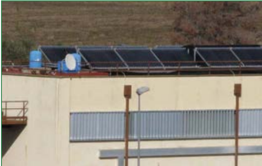
Campo solare Edificio F51 ENEA-CASACCIA
