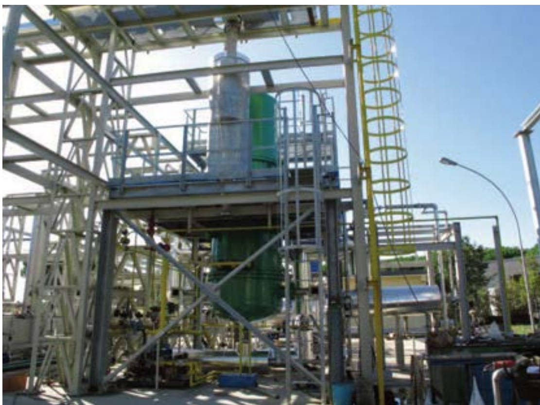
Impianto ZECOMIX per studi sperimentali sulla gassificazione del carbone per produzione di energia elettrica con emissioni zero
