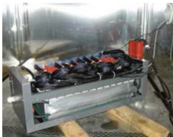
Il sistema di batterie usato come banco di prova per la messa a punto del prototipo finale
