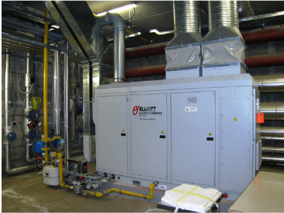
Figura 158. Impianto di cogenerazione con microturbina Elliott 100 del Politecnico
