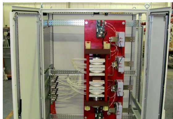
Figura 344. Armadio Making Switch con quattro tiristori in parallelo
