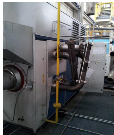
Figura 303. La microturbina svincolata dal vessel e resa operativa mediante il cross-piping
