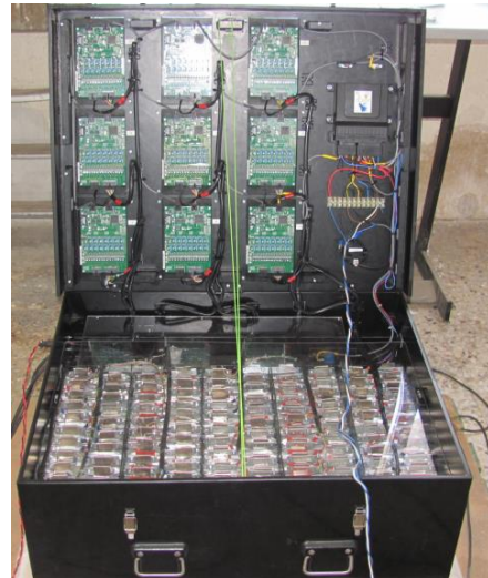
Figura 63. Vista della parte interna del pacco batterie
