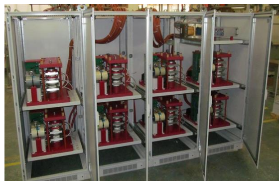
Figura 343. Armadio dell'interruttore SCB. Sono visibili gli otto moduli basati su IGCT
