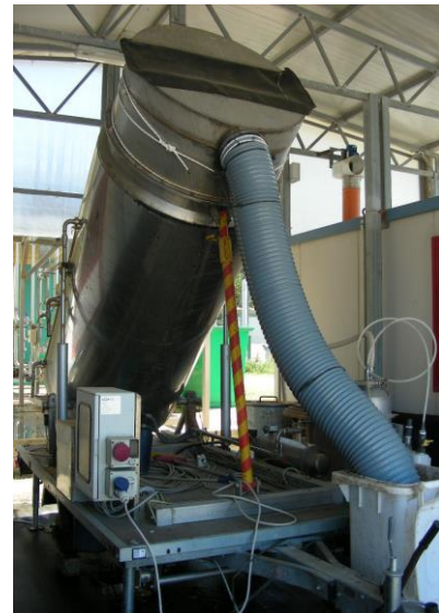
Figura 88. Impianto DMM2000 presso la discarica di Cupinoro (Bracciano, Roma)
