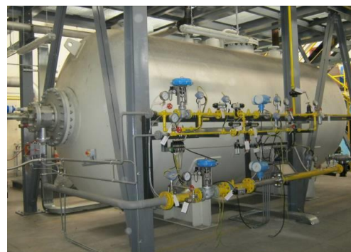
Vessel, vista lato combustore e rampa gas
