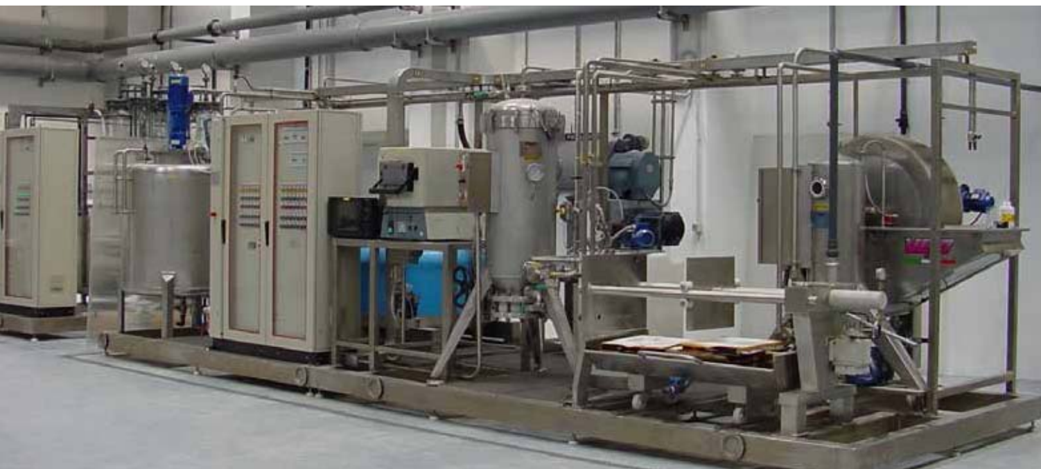
Figura 42: Particolare dell'impianto modulare CRISMAT
