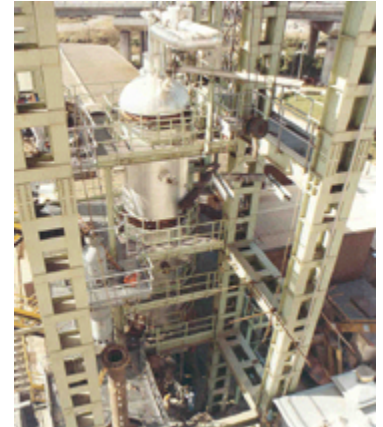
Impianto GEST: vessel (volume 43 m 3 , altezza 15 m)
