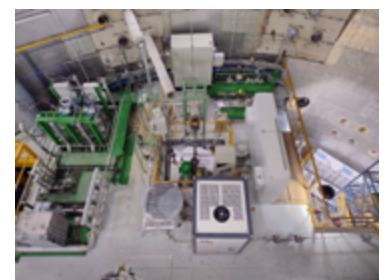
Impianto sperimentale CIRCE (vista dall'alto): sistemi e componenti ausiliari
