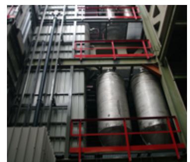
SPES-3 facility: vista dei compartimenti del contenimento (altezza totale 30 m)
