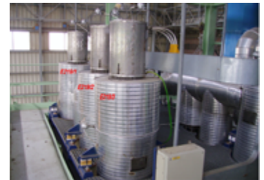
Impianto HeFUS3: in alto, la zona del turbo-circolatore e, in basso, i pozzi scaldanti.
