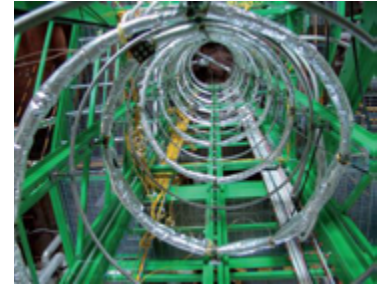
Impianto IETI: prove di scambio termico sui tubi elicoidali del generatore di vapore del reattore IRIS
