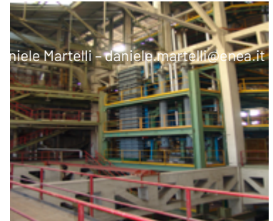
SPES-2 facility: vista dei sistemi di sicurezza passiva (altezza totale 30 m)
