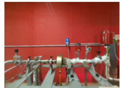
Impianto PERI II: in alto, impianto PERI II, in basso, particolare della sezione di testing.
