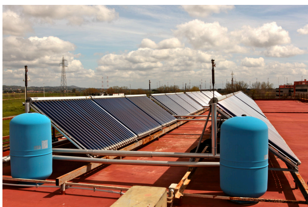
Impianto di solar cooling (Edificio F51) del CR ENEA Casaccia
