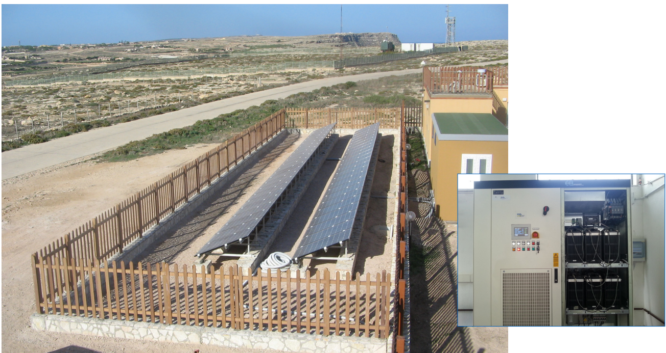
Impianto fotovoltaico con sistema di accumulo (nel riquadro) presso il CR ENEA di Lampedusa
