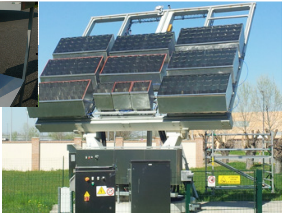
Figura 1b) Test facility per lo studio della tecnologia del fotovoltaico ad alta concentrazione installata presso la sede RSE di Piacenza
