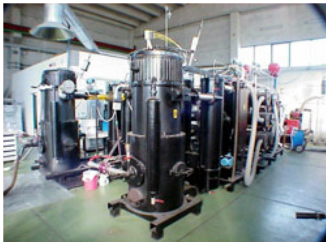
Impianto di gassificazione a letto fisso del CR ENEA Trisaia(Fonte ENEA)
