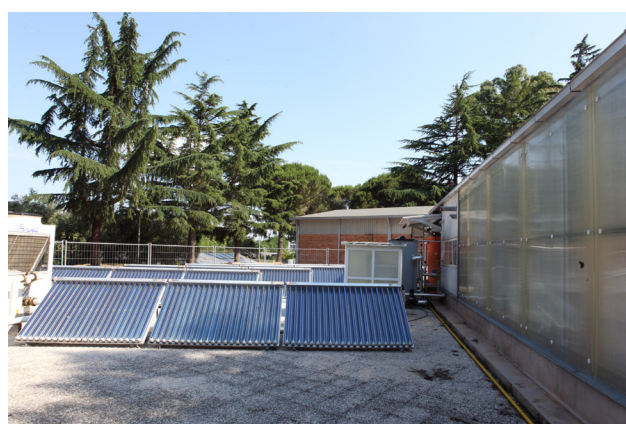
Impianto di solar cooling presso Edificio F96 "Serra a Contenimento" del CR ENEA Casaccia
