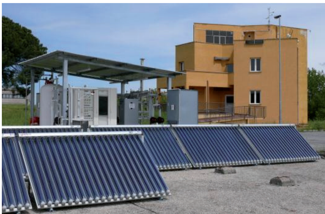
Impianto di solar heating and cooling presso Edificio F92 del CR ENEA Casaccia
