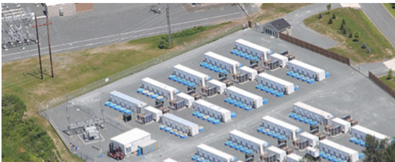
Impianto di volani (20 MW – 5 MWh) entrato in funzione nel 2011, Stephentown (New York)
