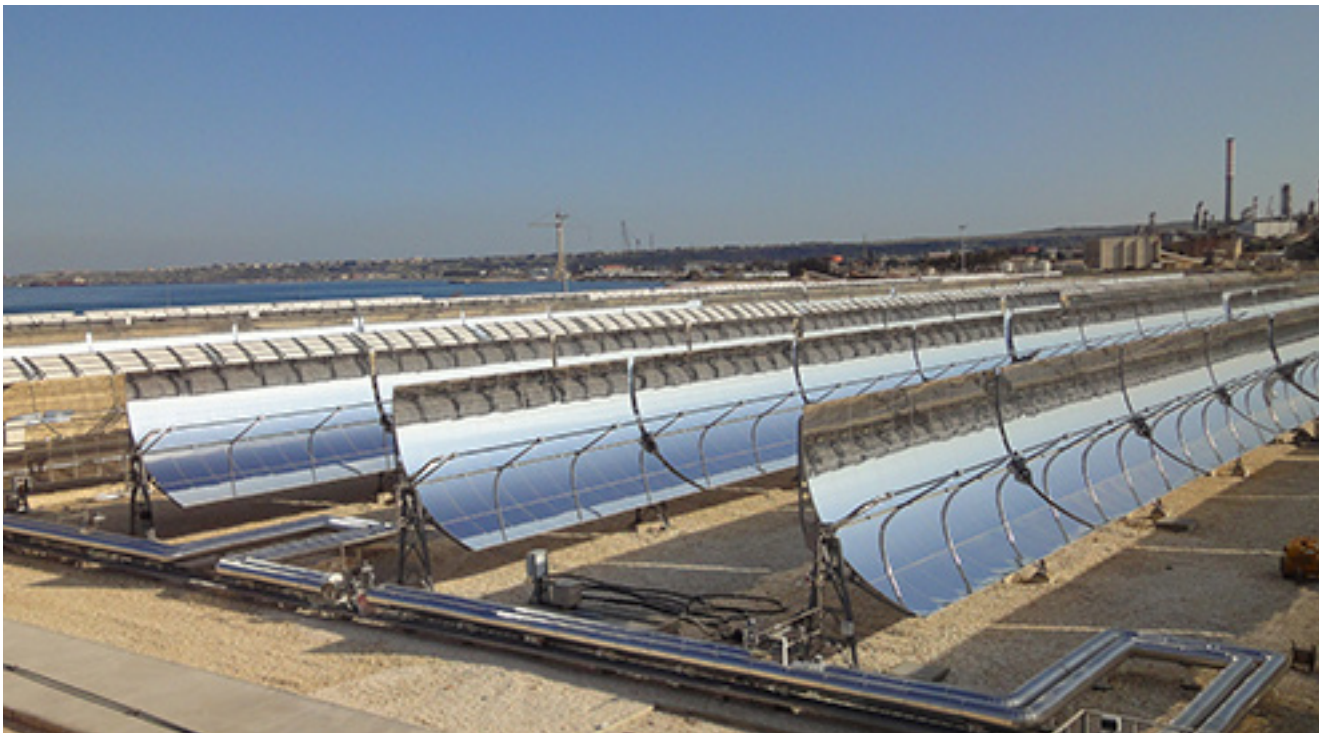
Collettori parabolici dell'impianto Archimede - Priolo Gargallo (SR) (Fonte: ENEL)
