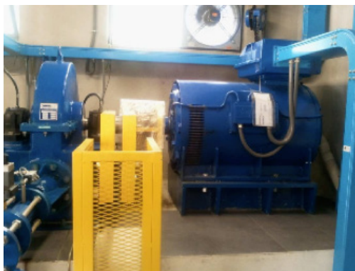
Centralina idroelettrica nell'acquedotto di Roncobello (BG) [18]
