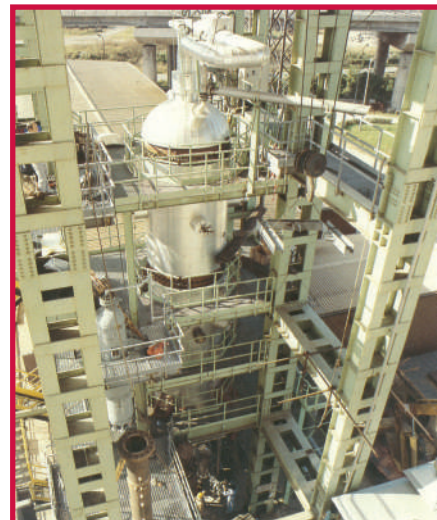
Vessel Impianto GEST (volume: 45 m 3 , altezza: 15 m)
