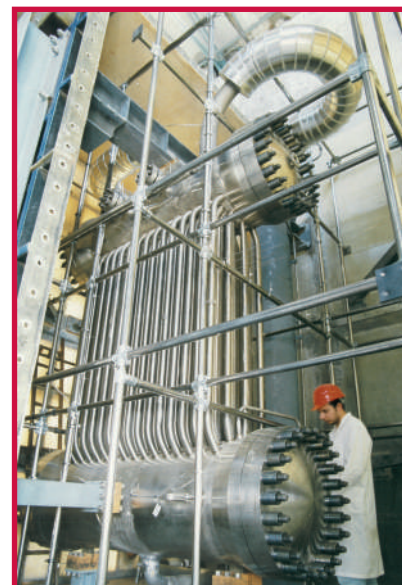
Isolation Condenser SBWR in prova su facility PANTHERS (potenza: 20 MW)
