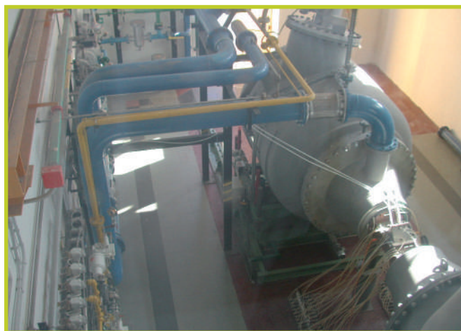
Locale impianto CERtem
