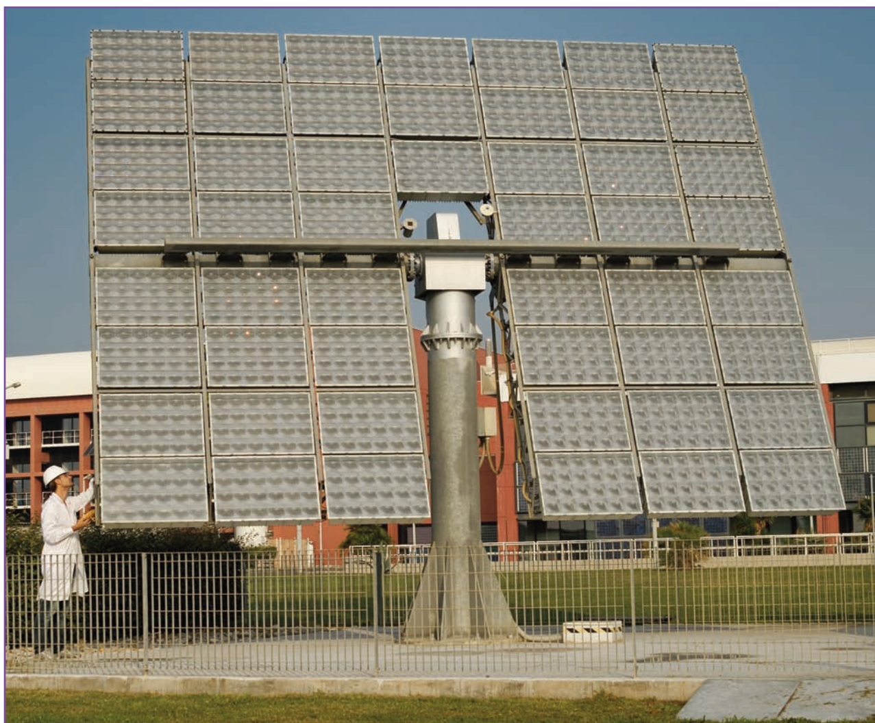
Impianto prototipale PhoCUS da 5 kWp basato sulla tecnologia a concentrazione point-focus
