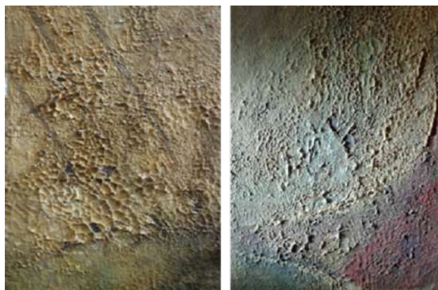
Fig. 7.11 - Sollevamenti e cadute di pellicola pittorica
