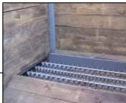
Sistema di coclee per l'estrazione del cippato dal silo
