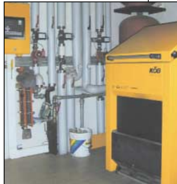
Caldaia a fiamma rovescia a tronchetti di legno
