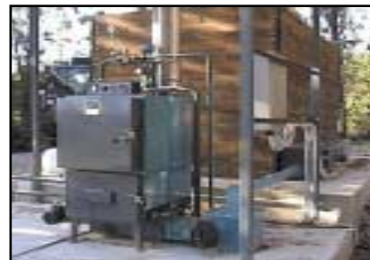
La caldaia e il silo di accumulo
