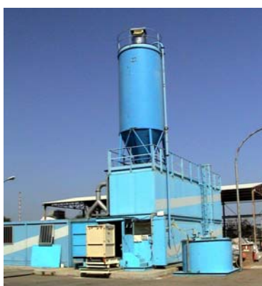
Figura 12 - Impianto ICAM per la stabilizzazione di amianto in matrice cementizia
