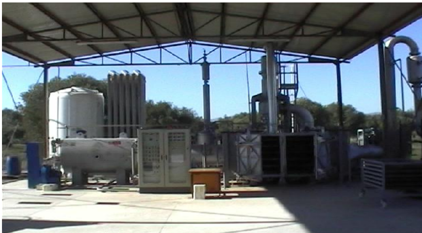
Figura 7 - Impianto pilota per la pirolisi a letto fisso nel Centro di Ricerche ENEA-Trisaia
