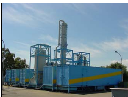
Figura 11 - Impianto DEDALO per il trattamento di percolati di discarica
