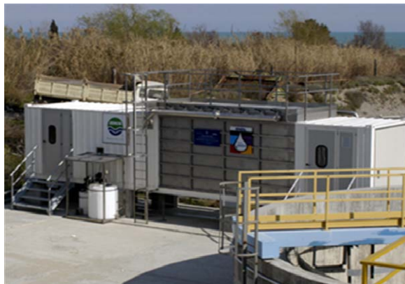
Figura 13 - Impianto per il trattamento terziario di acque reflue civili installato presso il depuratore di Rocca Imperiale (CS)
