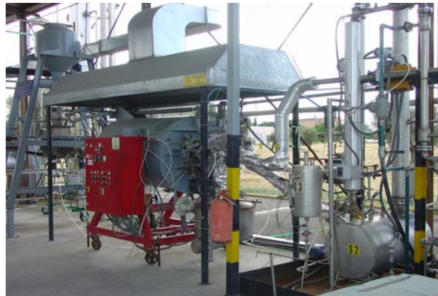
Figura 6 - Impianto pilota a tamburo rotante situato nel Centro di Ricerche ENEA-Trisaia
