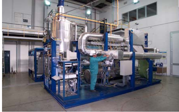
Figura 9 - Impianto LECOR nell'edificio sperimentale CPC1
