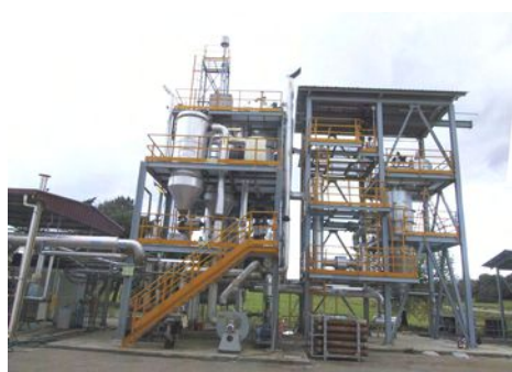
Impianto pilota della Trisaia (sezioni di gassificazione e purificazione)
