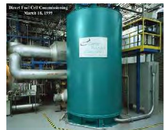
Impianto Direct Fuel Cell da 250 kW
