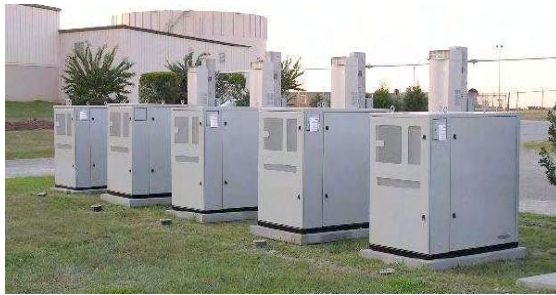
Unità GenSys 5 kW installate presso la base dell'Air Force di Robins (Georgia, USA)
