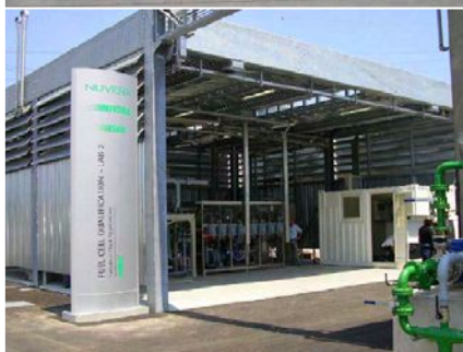
Modulo Forza 120 kW (8 stack) presso il laboratorio di qualifica celle a combustibile Siad/Rivoira (Osio, BG)
