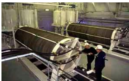
Norsk Hydro Electrolysers (485 Nm 3 /h)
