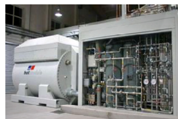
Sistema HM 300 alimentato a biogas (Leonberg)
