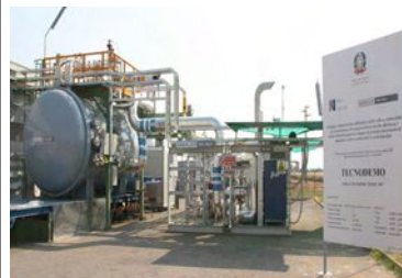
Impianto Tecnodemo da 125 kW (Bosco Marengo, I)
