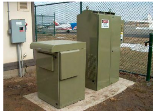
Unità GenCore e modulo di accumulo idrogeno
