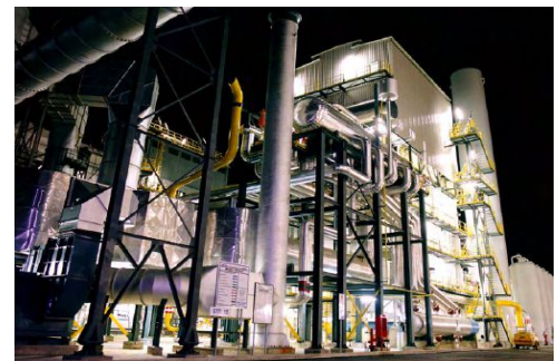
Impianto di steam reforming realizzato dalla Linde (Milazzo, Italia) - Capacità produttiva 65.000 Nm 3 /h
