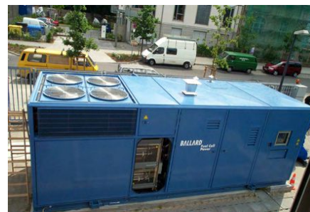
Impianto Ballard 250 kW, Bewag Treptow Heating, Berlino (D)
