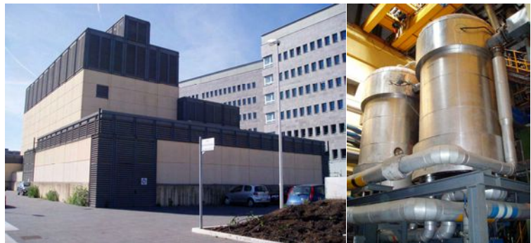
Impianto PAFC da 1.3 MW Milano-Bococca
