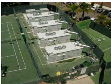
Unità DFC300, San Diego Sheraton West Tower
