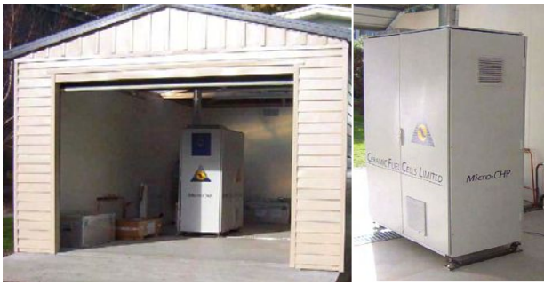
Sistema CHP-2 (Wellington, Nuova Zelanda)
