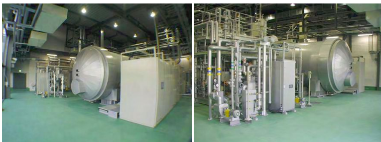
Unità MCFC da 300 kW - IHI / Chubu Electric Co.
