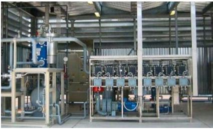
Impianto Forza da 120 kW presso i laboratori di Osio
