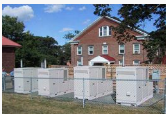
Unità Plug Power da 5 kW Watervliet Arsenal, NY
