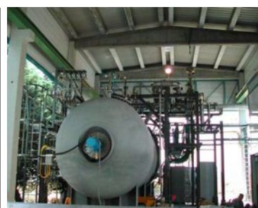
Impianto "First of a kind" da 500 kW (S. Agustin de Guadalix, E)
