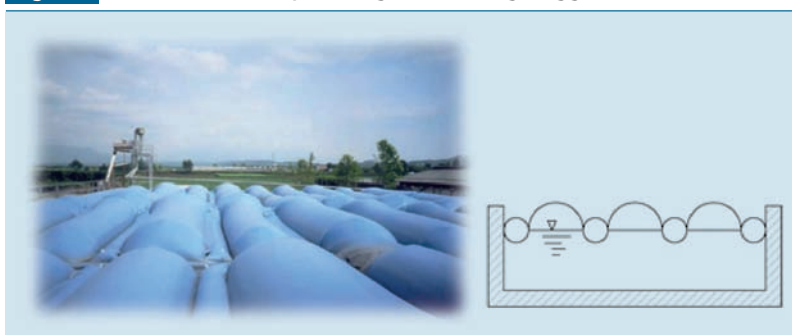
Fig. 2.3 Copertura gasometrica galleggiante
