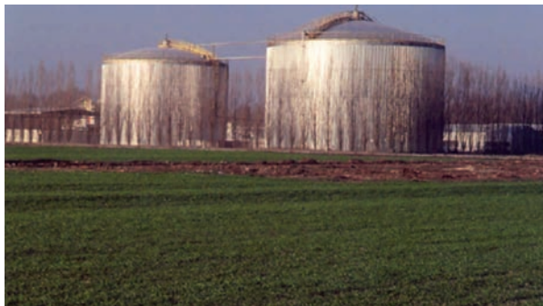
Figura 2.4 Impianto centralizzato a doppio stadio, Spilamberto (MO)
