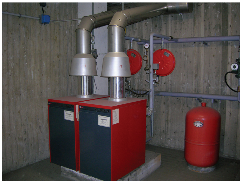
Foto 3.1 – Caldaie di piccole dimensioni al servizio di un singolo edificio (circa 75 kW t )
