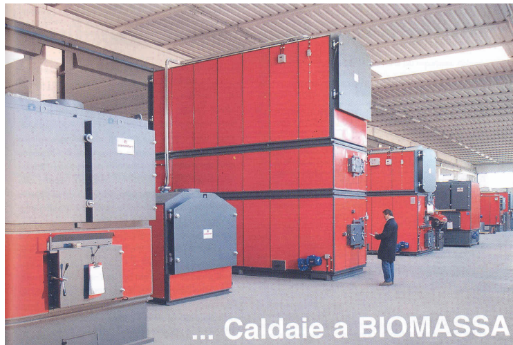
Foto 2.6 – Caldaie a biomassa di medie dimensioni (3-5 MW)
