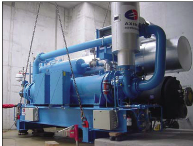
Foto 2.9 – Pompa di calore da 3 MW i installata presso l'impianto di Bergamo Centro
