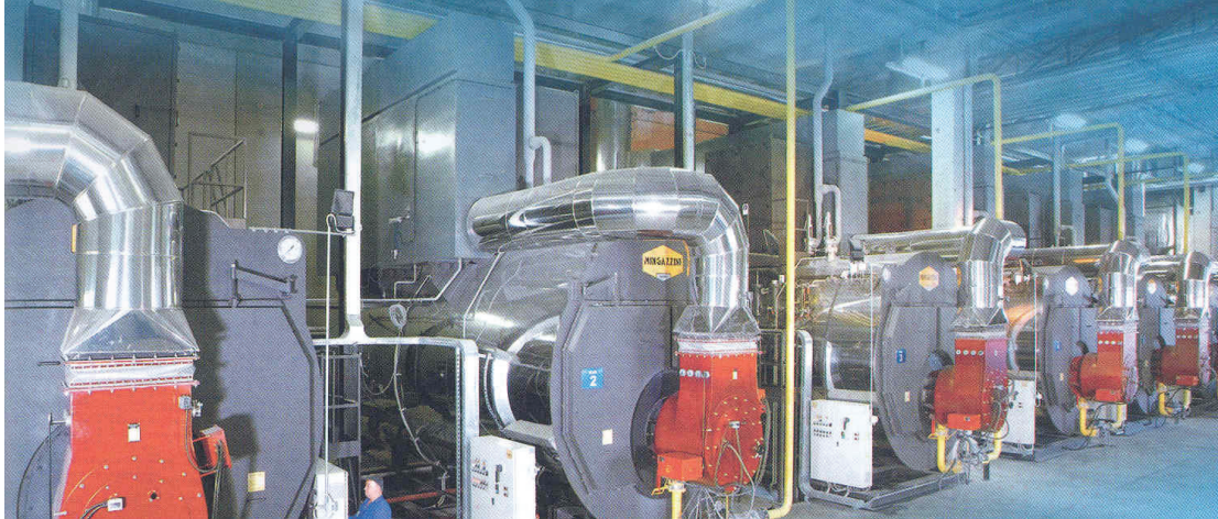
Foto 2.4 – Caldaie di integrazione a gas naturale
