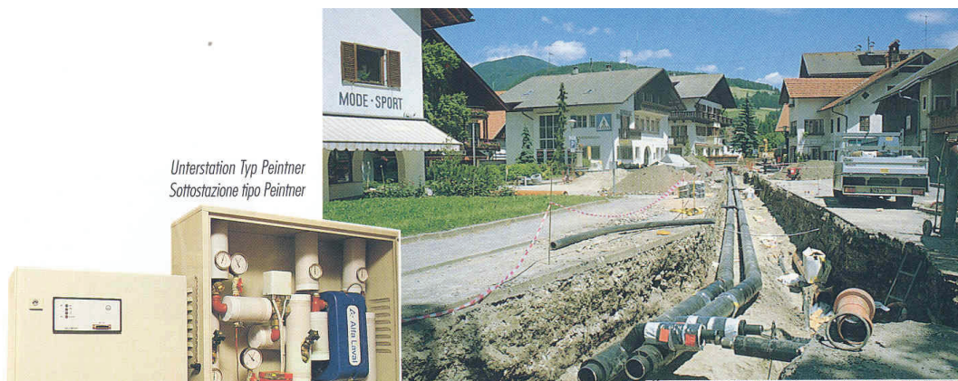
Foto 2.7 – Le reti di teleriscaldamento alimentate a biomassa sono diffuse prevalentemente nei piccoli e medi centri alpini
