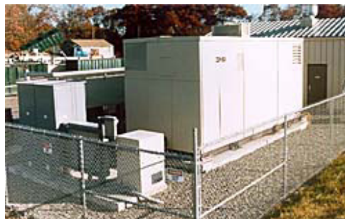
Figura 3.20 - Sistema costituito da celle PAFC da 200 kW
