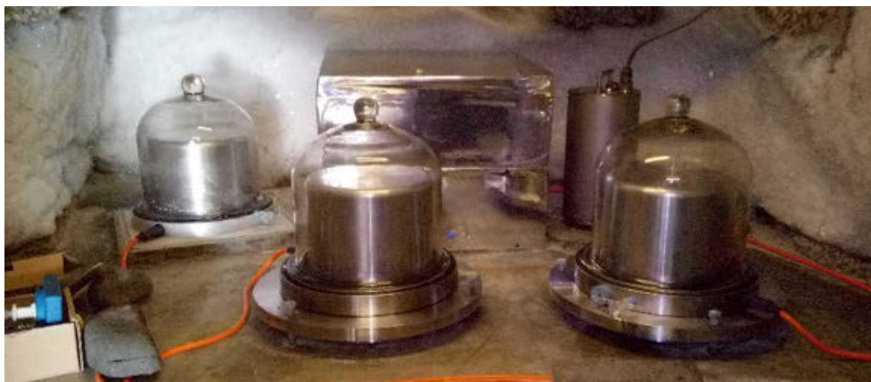
Prog. OSS-07: Basamento dei sismometri
