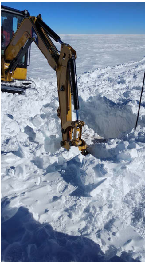
Prog. OSS-02: Recupero del sensore installato durante la campagna precedente
