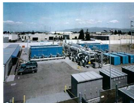
Impianto da 1,8 MW a S. Clara (CA, USA)
