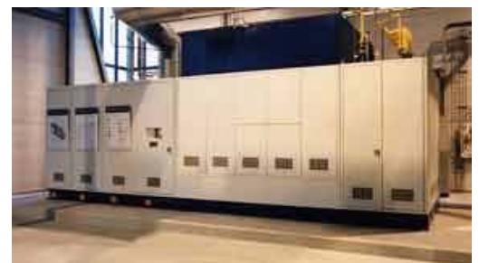
Impianto SOFC da 100 kW EDB/ELSAM
