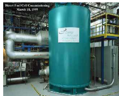
Impianto Direct Fuel Cell da 250 kW
