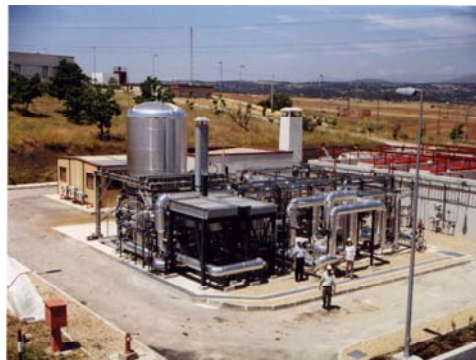
Stazione di prova PEP Iberdrola a S. Augustin de Guadalix (Madrid, E)
