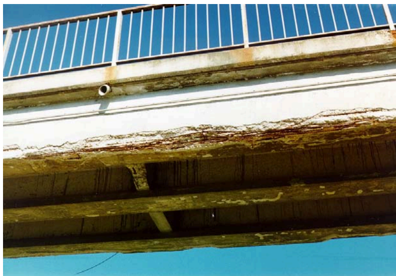
Foto 11.3 - Il degrado delle travi
