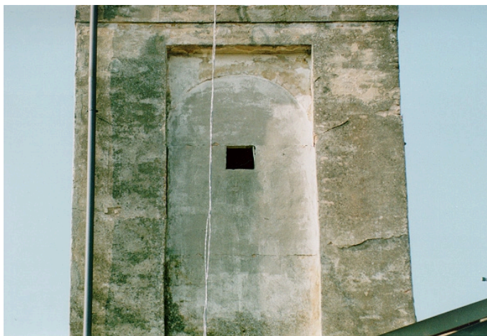
Foto 8.2 - Particolare della lesione
