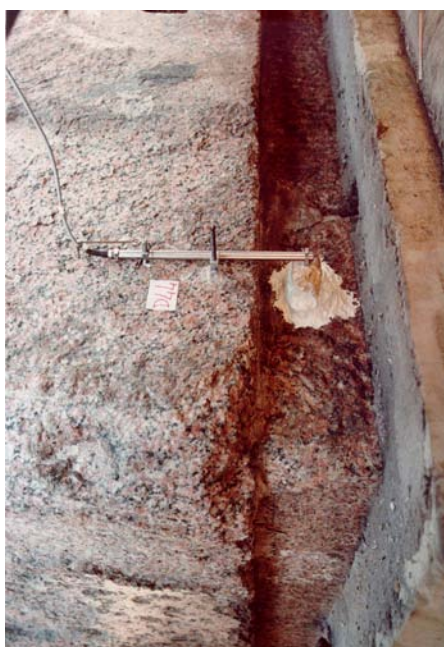
Foto 2.3 - Trasduttore di spostamento relativo alla base
