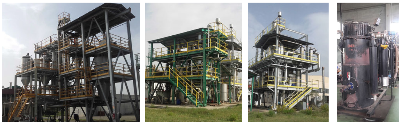
Figura 28: Impianti di gassificazione biomasse
