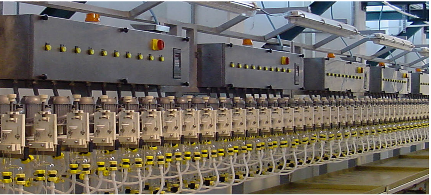
Figura 33: Impianto Terre Rare
