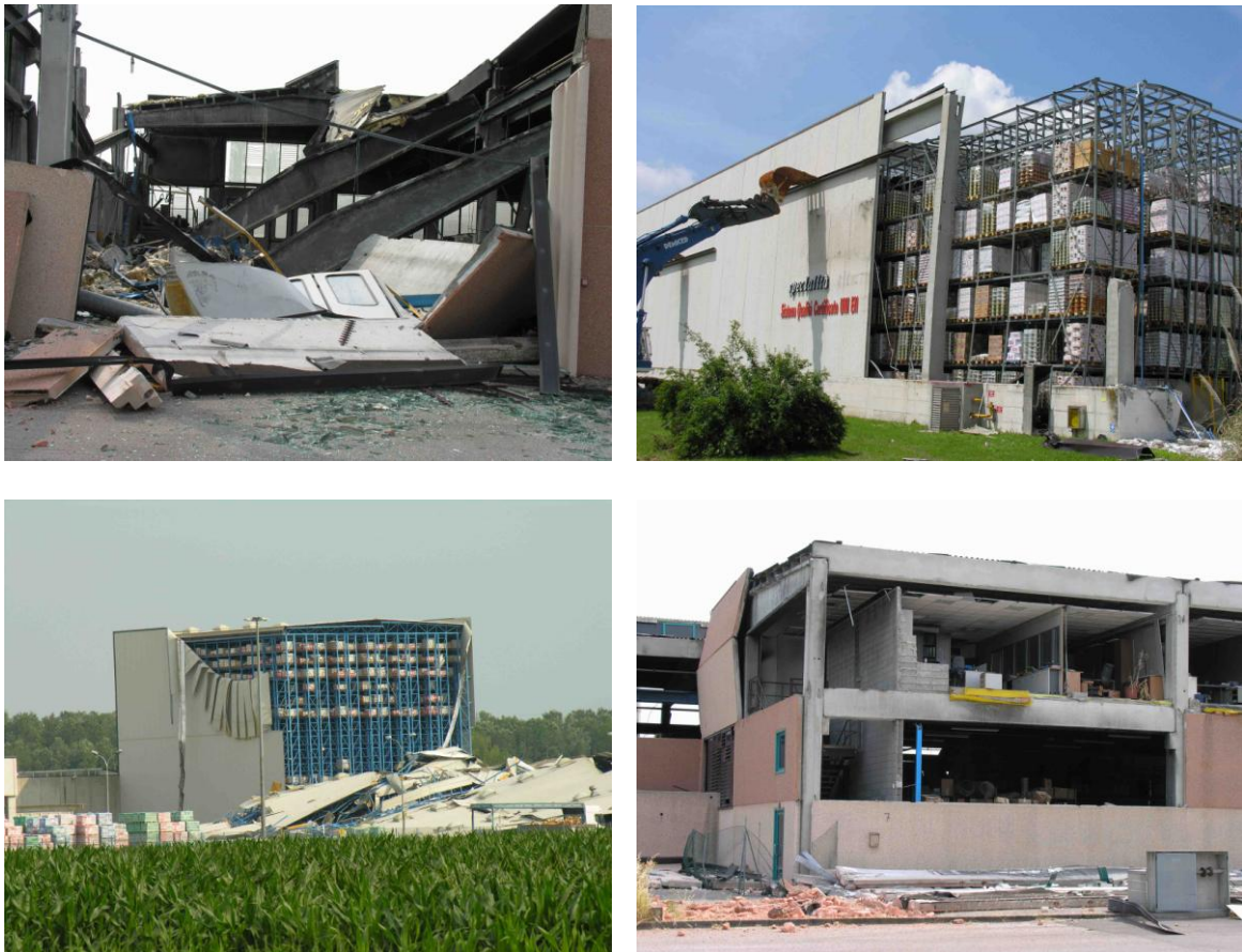
Fig. 6 Edifici industriali fortemente danneggiati dal sisma emiliano del 2012
