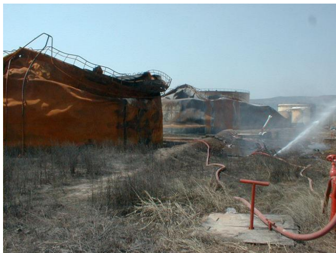
Fig. 2 Terremoto di Izmit (Turchia), 1999, M_w=7.4 : incendio e conseguente collasso di un serbatoio di stoccaggio nella raffineria di Yarimca; l'incendio ebbe gravissime conseguenze in termini di inquinamento atmosferico e problemi di approvvigionamento
